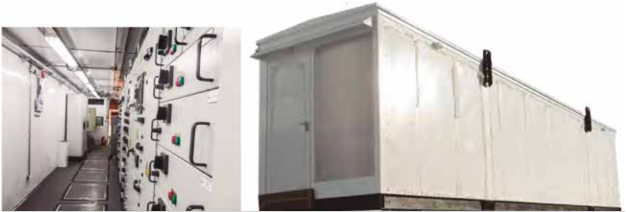
Figura 6. Aplicación en “La amarga chica”, de Pecom: sala eléctrica de 12 m de largo, 2,6 de ancho y 3 de alto
