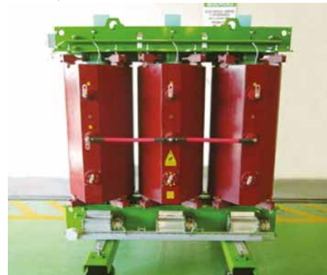
Transformador encapsulado elevador YNd11, con ventilación forzada
