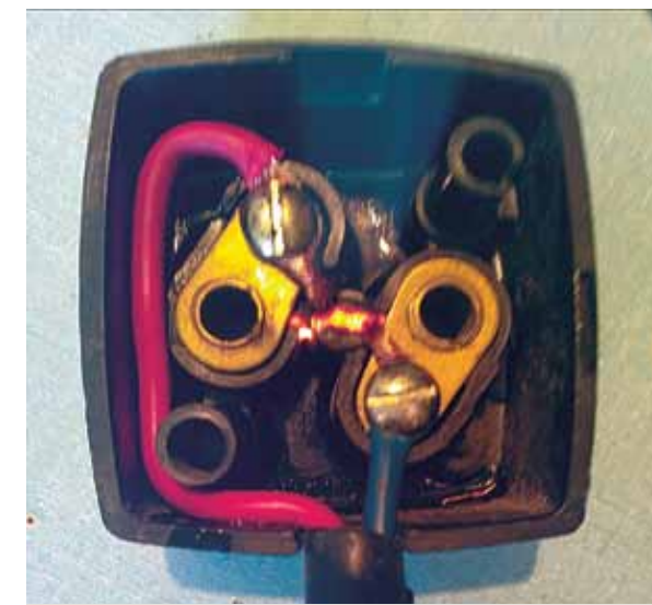
Figura 5. Arco paralelo en el interior de un toma bipolar
