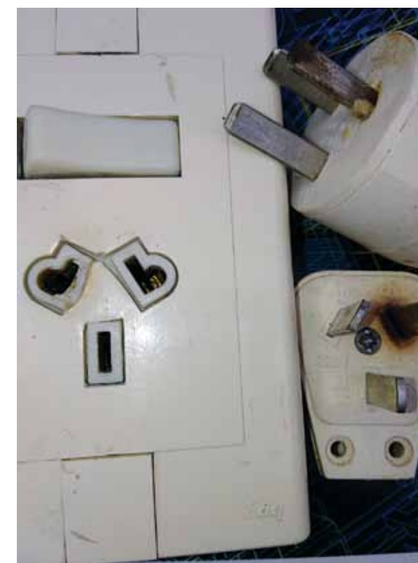
Figura 3. Fichas dañadas en sus espigas de neutro debido al falso contacto (arco serie) en un tomacorrientes no reglamentario, que por ser binorma presenta menor superficie de contacto.
