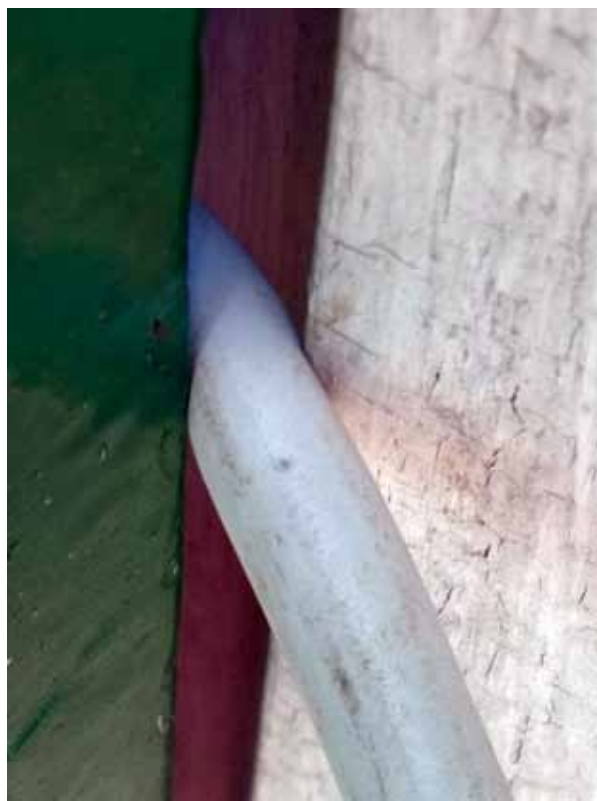
Figura 4. Aislaciones interiores dañadas por cizallamiento de cordón bifilar (arco paralelo). Si el cordón hubiese sido trifilar, la propagación al conductor de protección equipotencial del arco habría disparado el interruptor diferencial.
