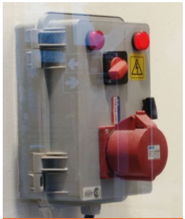
Figura 1. Tablero de transferencia manual y conexión rápida y segura a grupo electrógeno ajeno
