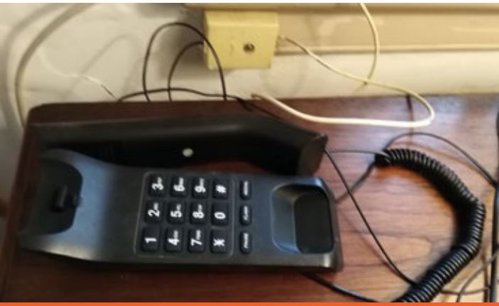
Figura 2. Teléfono de línea: recibía alimentación extremadamente segura de la central telefónica
