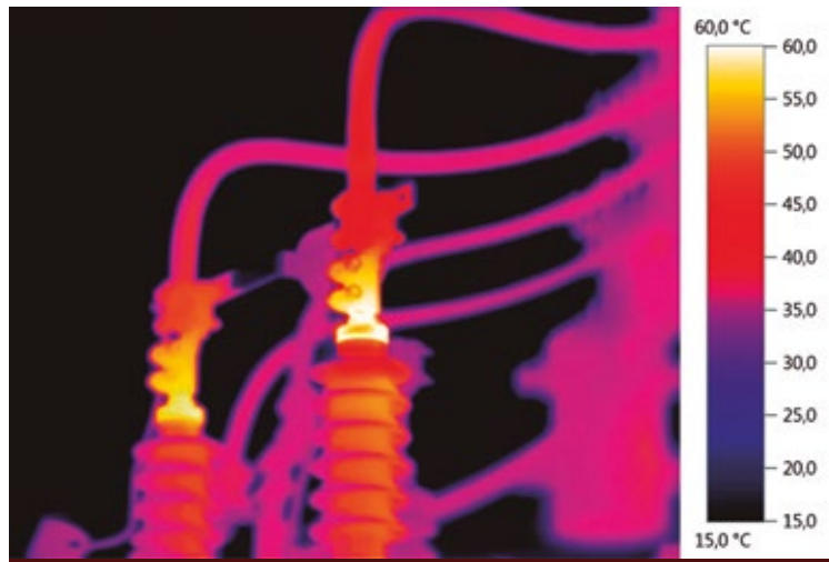
Figura 2. Inspección termográfica de transformadores, aisladores y uniones roscadas
