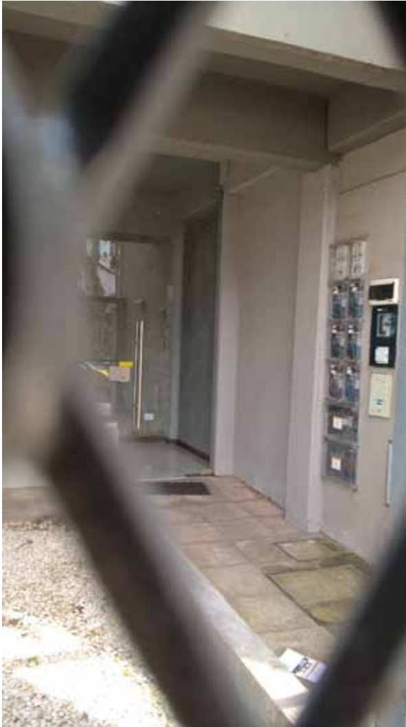
Figura 3. Batería de medidores tras la reja
