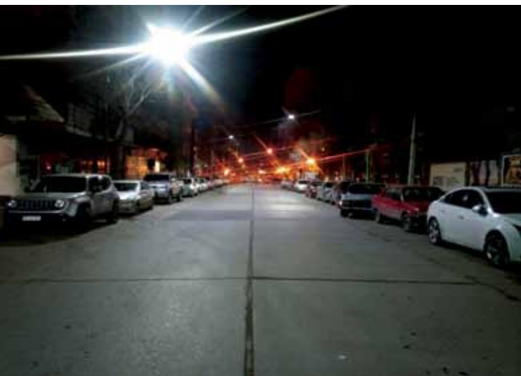
Figura 3. Calle C.H. Rodríguez iluminada con led de 190 watts. Al fondo, la exiluminación con sodio de 250 watts
