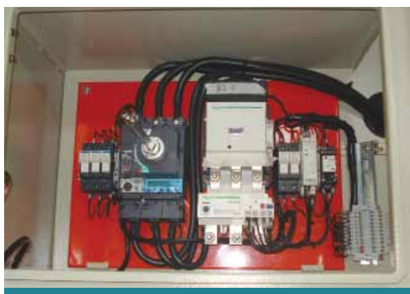
Figura 7. Compartimento de un MET en un tablero eléctrico
