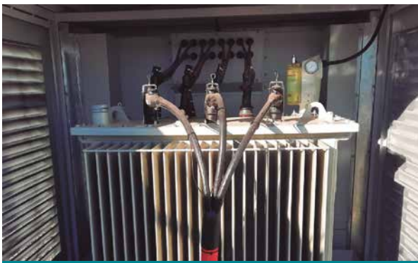
Figura 5. Acometida en media tensión y salida en baja tensión protegidas, en el centro compacto. Mayor seguridad.
