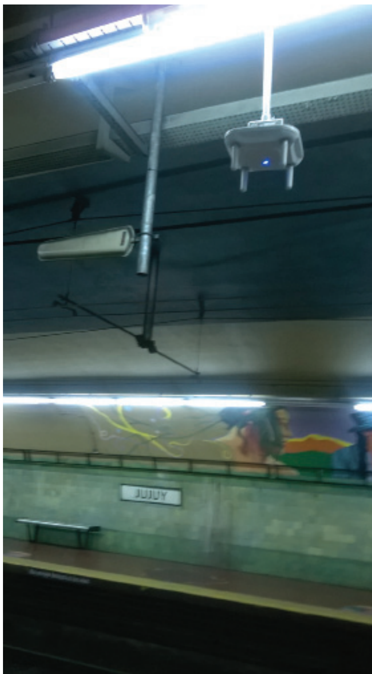
Antena y router en estaciones de subte
