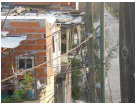
Redes aéreas precarias
