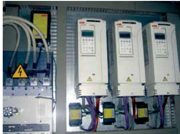
Protección de variadores
