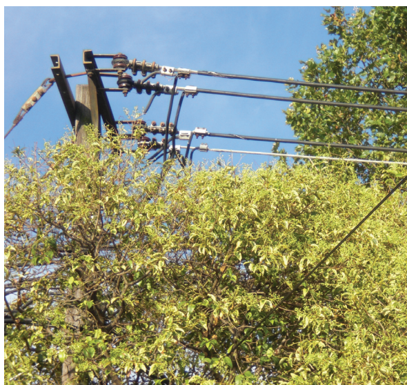
Foto1. Línea aérea abierta coplanar de baja tensión
