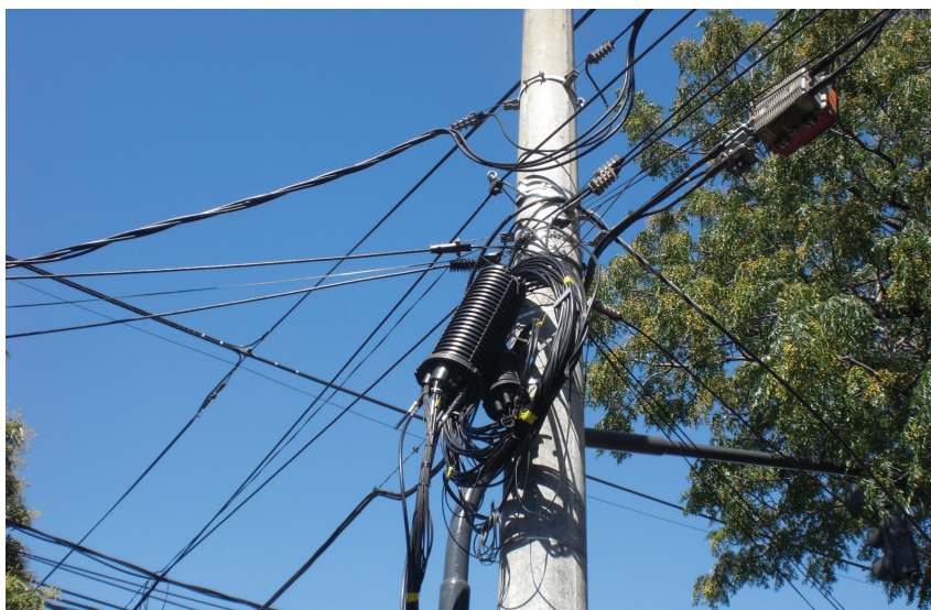
Imagen 3. Detalle de las fotos anteriores destacando la amenazante proximidad de una columna metálica de alumbrado público que se suma a las instalaciones de televisión por cable e Internet favorecedoras de posibles contactos a tierra
