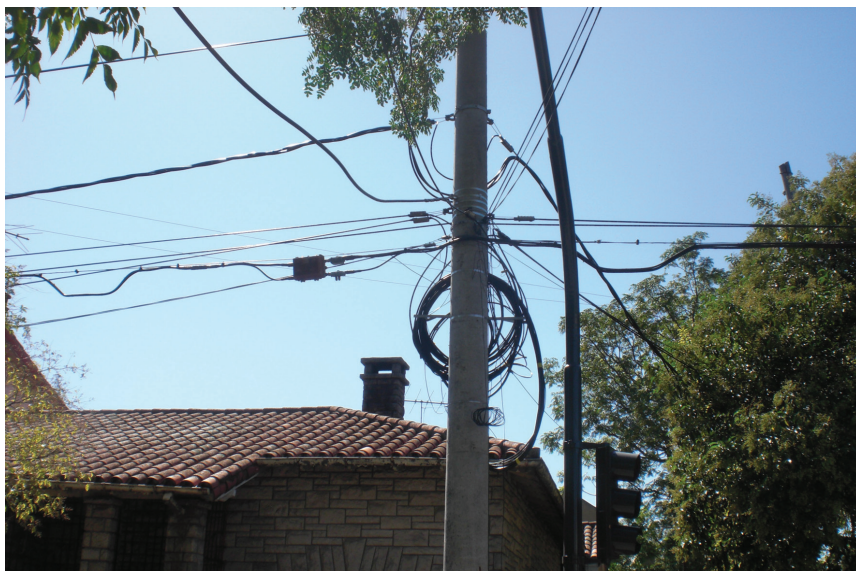
Imagen 2. Imagen panorámica que a su izquierda muestra una caja de empalme y amplificador de televisión por cable e Internet situados al acaso como ocurre en la generalidad de este tipo de instalaciones
