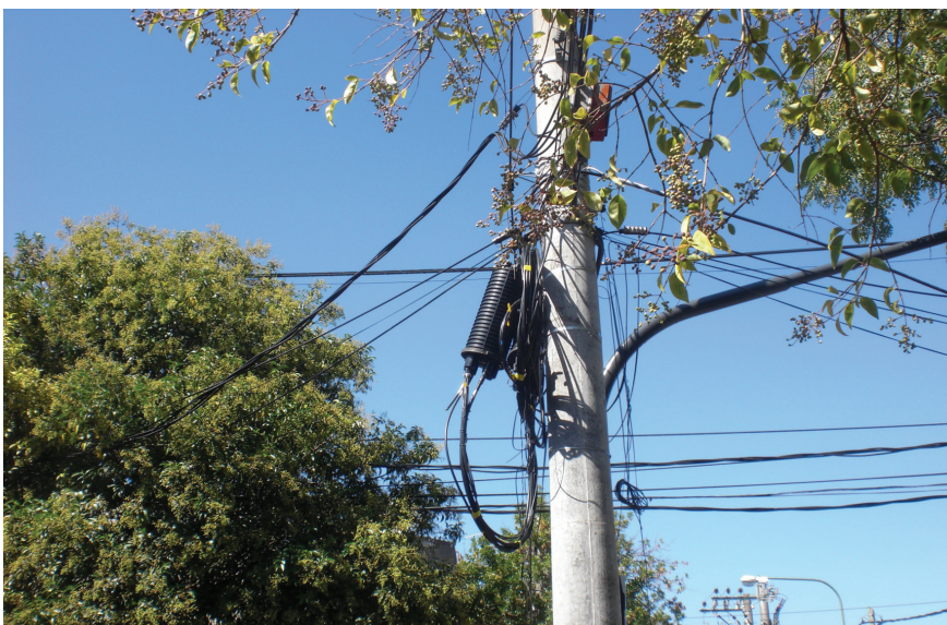
Imagen 1. Empalmes de fibra óptica dificultando el acceso a la caja metálica oxidada (poste de hormigón, arriba a la derecha) que contiene fusibles NH donde el nivel de cortocircuito es muy alto a juzgar por la proximidad de la plataforma transformadora que se observa en el ángulo inferior derecho de la foto
